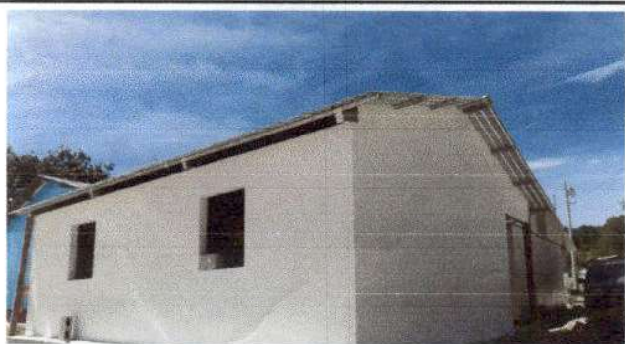
Foto 5: Repello en muro exterior en módulo de cocina.
